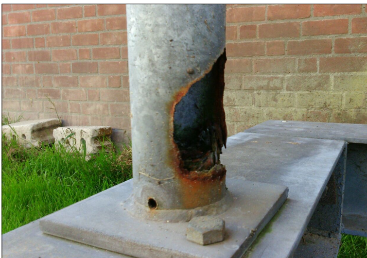
Ondeugdelijke staat silo
